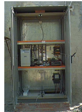
Figura 5 – Carpenteria che ospita le apparecchiature di monitoraggio.
